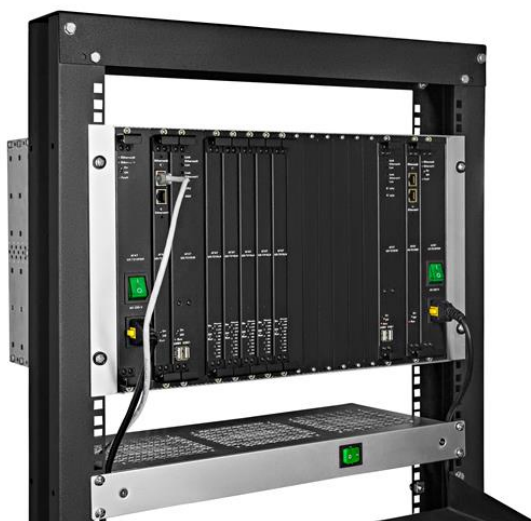
Рис. 1 - Фотография ведущего и вентиляторного блоков IP-АТС в телекоммуникационной стойке
